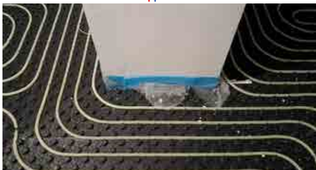
Sistema di riscaldamento a pannelli radianti
