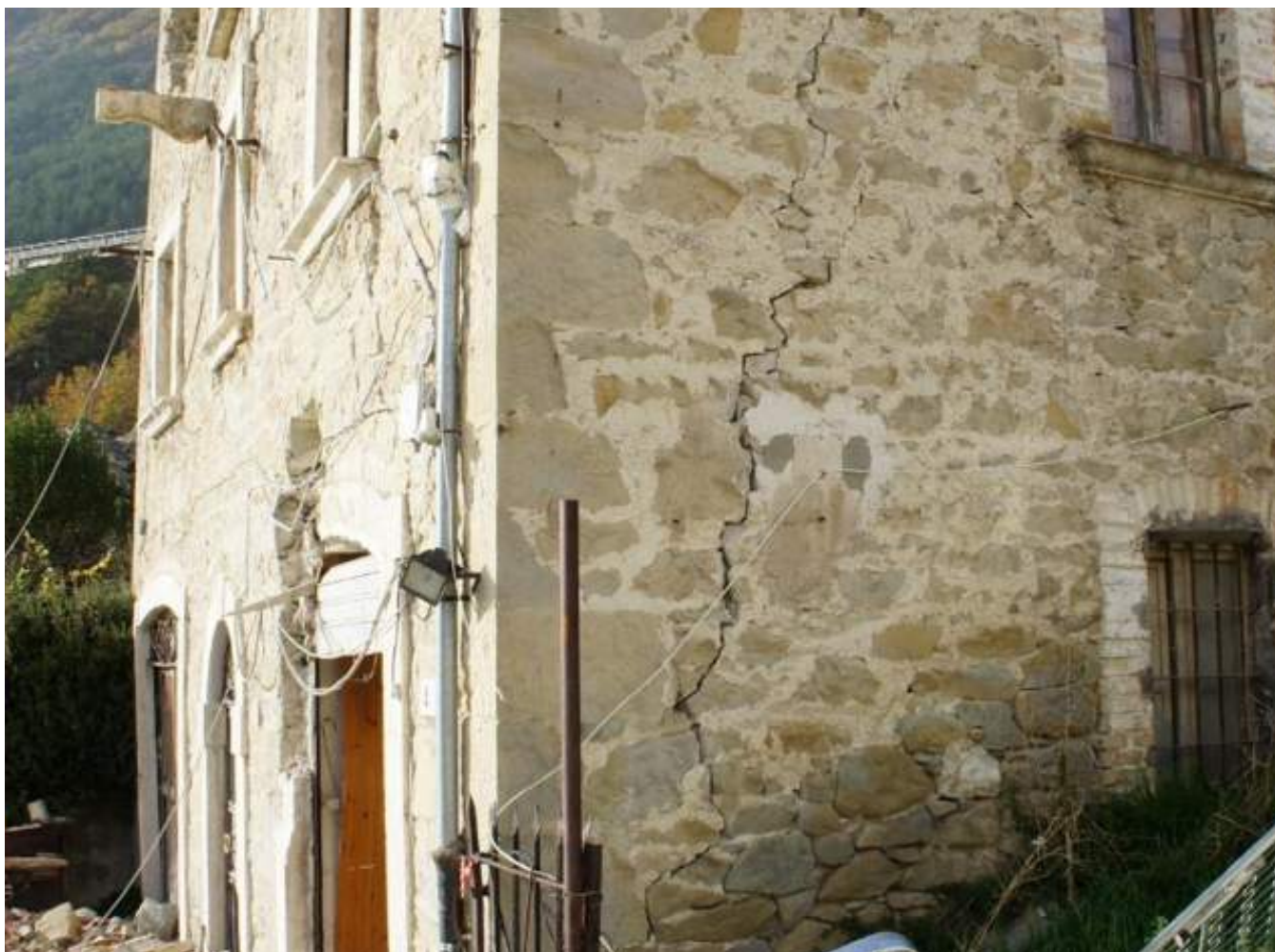
3- Attivazione di meccanismo locale di ribaltamento di facciata
