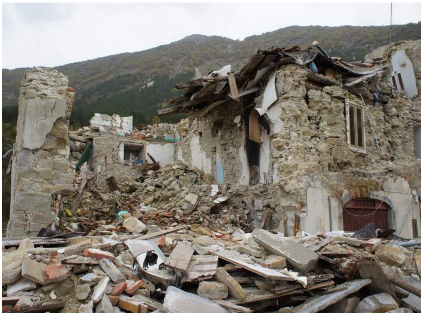
1- Collasso per disaggregazione della muratura
